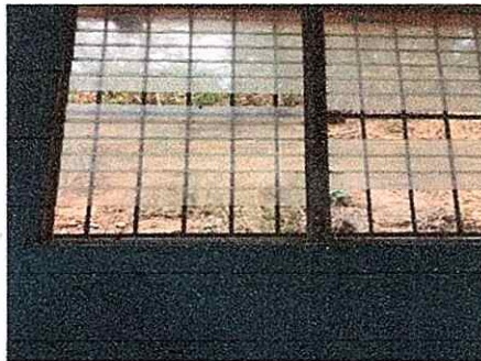
Foto 3: se observa deterioro de las ventanas.
