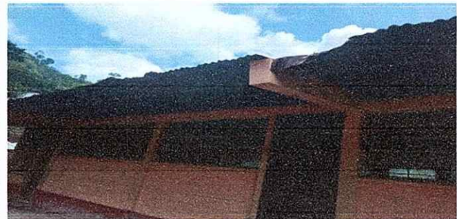
Foto 6: techo en mal estado
